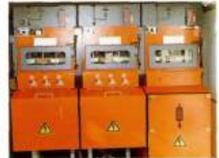
איור 3 מסדר מתח גבוה
