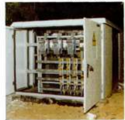
איור 4 לוח חלוקה ואבטחה במתח נמוך
